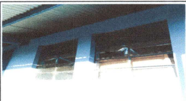
Foto 3: Sustrucción de vidrios (modulo de aula)
